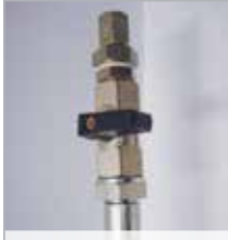
Valve au bout du tuyau : fermée
